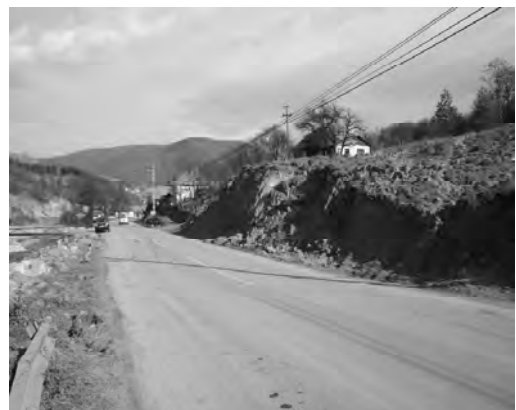
Fig. 14. Corpul unei alunecări de teren care a afectat șoseaua Onești-Slănic Moldova
